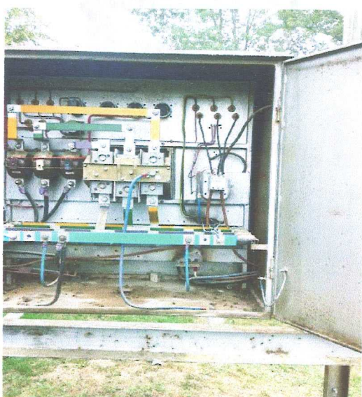
Slika 24. RO blok u ŽSTS Kladavac 1
