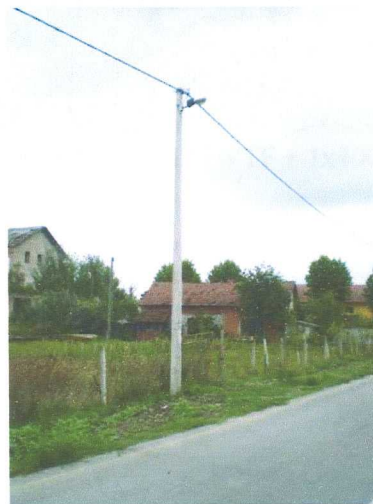
Slika 2. LVC-06 na betonskom stupu
