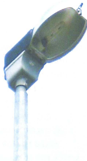
Slika 15. LVC-16 nedostaje kapa (problem kopče)
