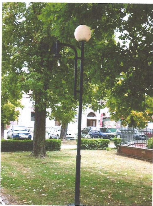
Slika 14. KUGLA KS-10 nedostaje kapa
