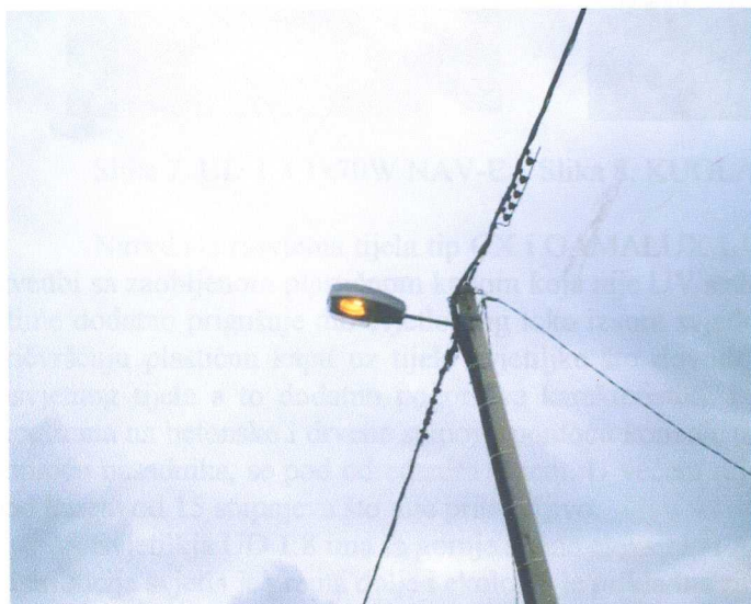
Slika 3. CX 62.6 na betonskom stupu
