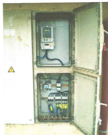
Slika 17. Upravljački ormar PTS Babina Greda 2
