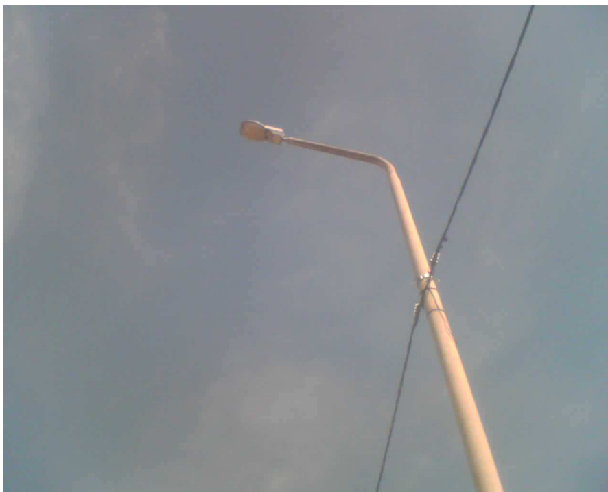
Slika 1. Betonski stup + bet. lira + GAMALUX LVC-06 1x150W NAV-E
