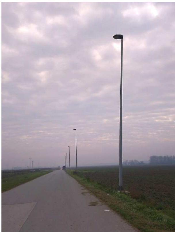
Slika 2.1. Kaos NAV 250W na čeličnom stupu JR Poslovna zona Ambarine
