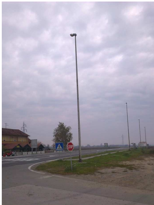
Slika 2.2. Gamalux 250 W na čeličnom stupu JR križanje državne ceste D55 i Poslovne zone
