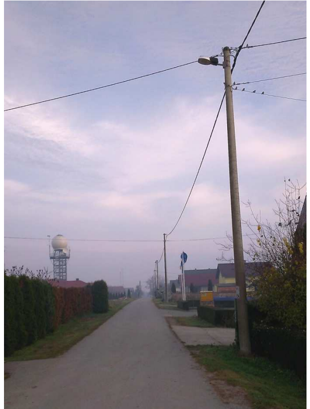
Slika 2.6. Gamalux LED 60 W na betonskom stupu NN mreže Malo Brdo
