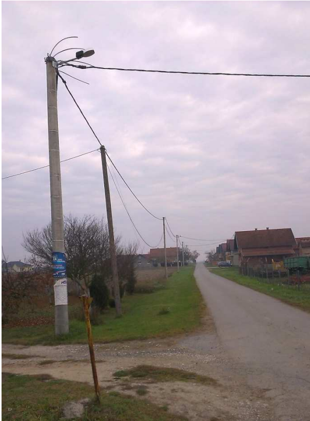
Slika 2.5. Gamalux NAV 150 W na betonskom stupu NN mreže Grbavica
