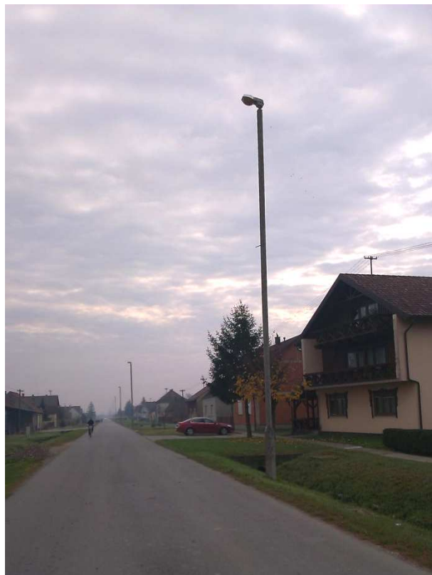
Slika 2.4. Gamalux NAV 150 W na betonskom stupu JR Ulica Matije Gupca
